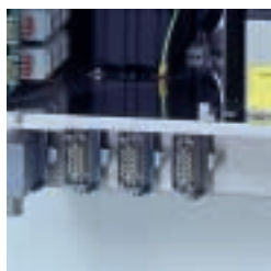
Разъемы в шкафу управления
